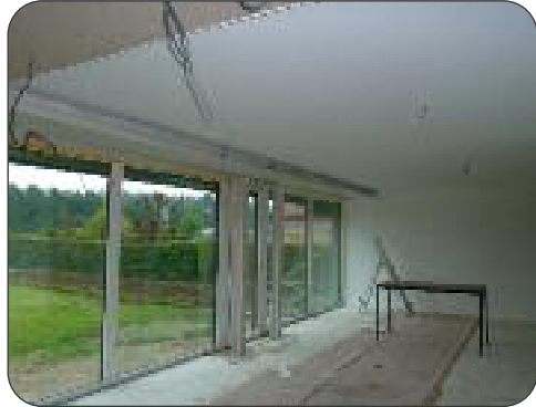
Het vals plafond wordt niet over de hele ruimte doorgetrokken. Zo blijft de thermische massa van de betongewelven direct aanspreekbaar ten behoeve van maximaal wooncomfort.
