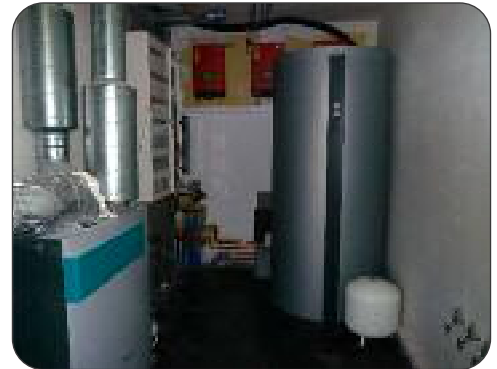
De technische berging huisvest onder andere de balansventilatie, een buffervat van 950 liter, de omvormers van de fotovoltaïsche panelen, de domoticakast,...
