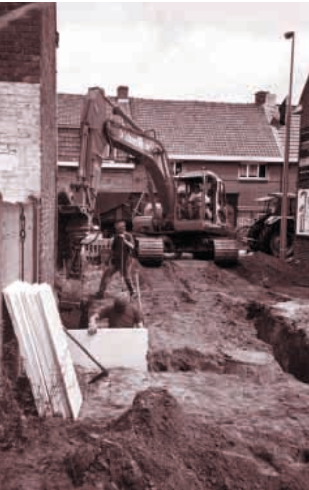
HET PLAATSEN VAN PERIMETERISOLATIE IN DE FUNDERINGS-SLEUVEN IS EEN MONNIKENWERKJE VOOR DOORWINTERDE KOUDEBRUGHATERS. PERIMETERISOLATIE VERMINDERT DE THERMISCHE SCHOMPMELINGEN OP DE FUNDERINGEN, OPSTAND EN VLOERPLAAT.
