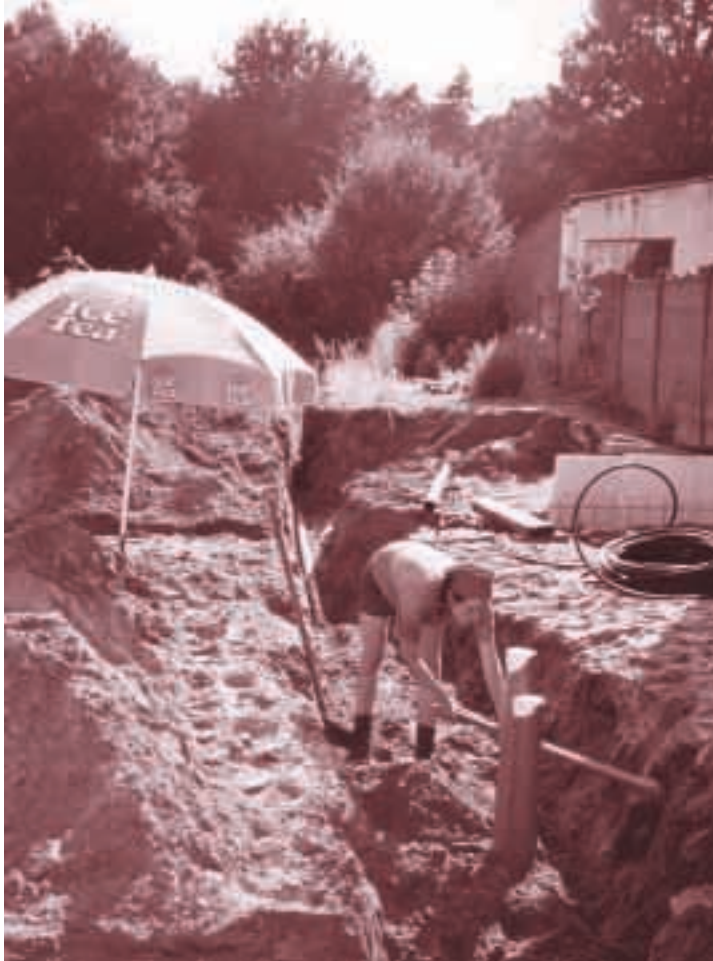
MYRIAM IN DE TOEKOMSTIGE KEUKEN "NOG EVEN DE SLEUF VAN DE GRONDBUIZEN DICHTEN EN HET VLOERTJE AANVEGEN..."
